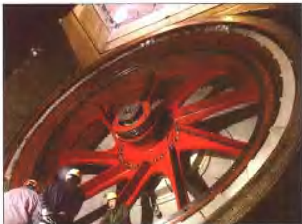
电站机组发电机检修
